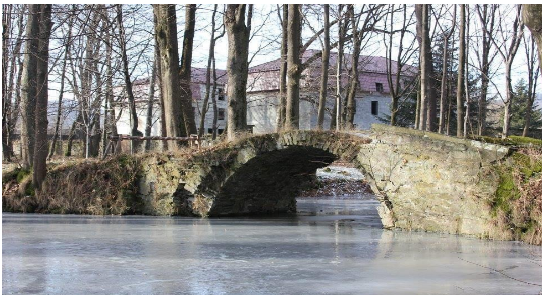
Mostek przed remontem
